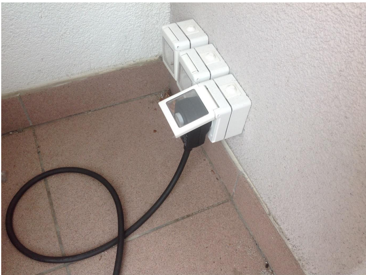
Slika 2: Domača sončna energija, priklop na vtičnico
